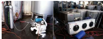
Bombas y filtros mecánicos de "Lomas de Cauquenes"
