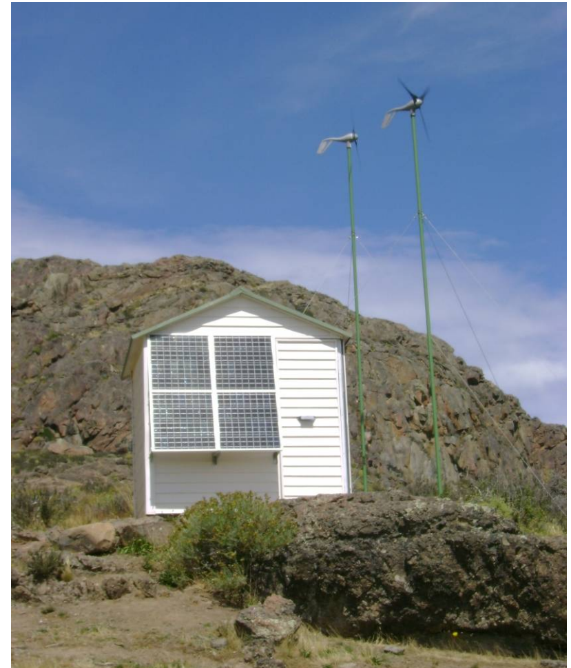
·Paneles Fotovoltaicos y Generadores Eólicos Existentes.
