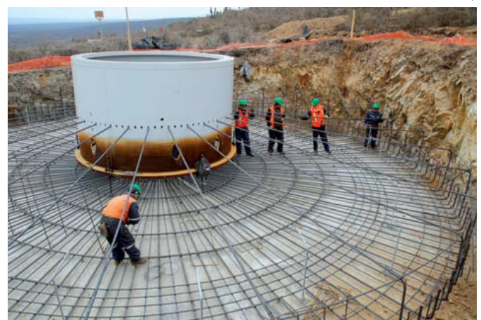
Excavación y construcción de fundación para un aerogenerador. (Fuente: Reportaje sobre Parque eólico Canela I, Revista BIT N58, enero 2008)
