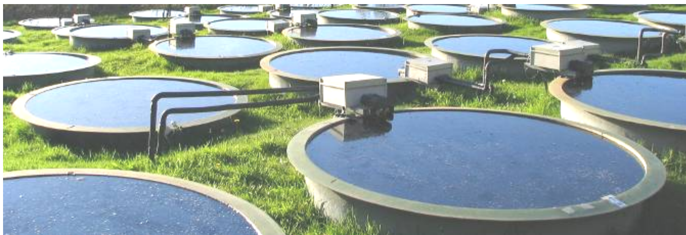
Estancos de Fitorremediación
