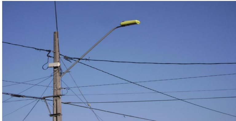
Figura N°12: Luminaria instalada en barrio Los Almendros
