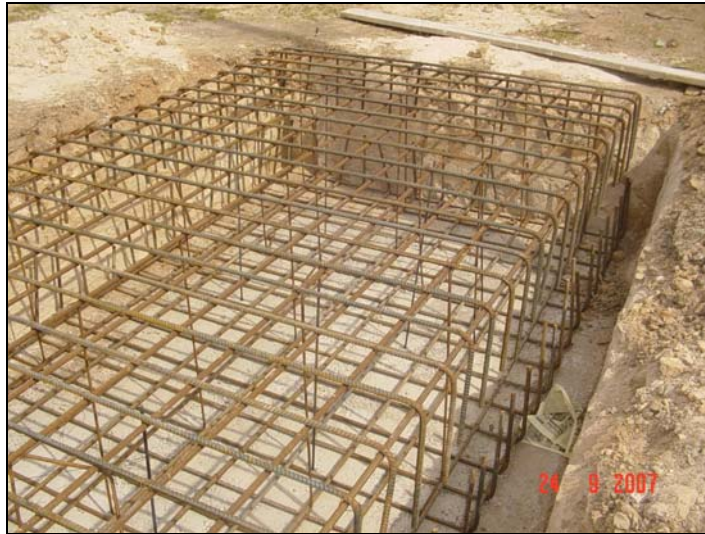
Fig. B. 1: Armadura en losa de hormigón (7x2,6m). Barras A63-42H ( \Phi 18mm) con resalte.
