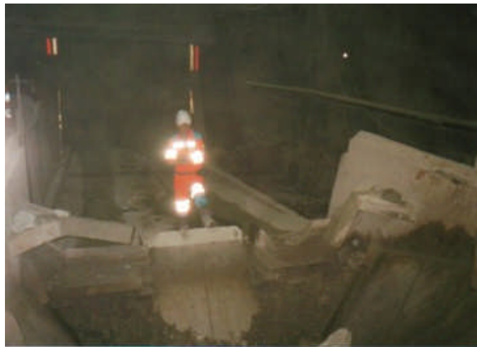
Figura 25: Estación sizer fijo, sector rampa de descarga camiones.
