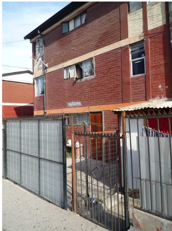
Figura E4: Fachada con modificación al agregar una puerta.
