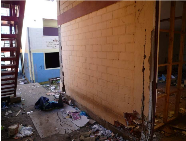
Figura 12: Grietas verticales en muro de fachada de albañilería. Esta falla ocurre justo entre el paño de albañilería y el pilar. Además el pilar presenta pérdida de hormigón.
