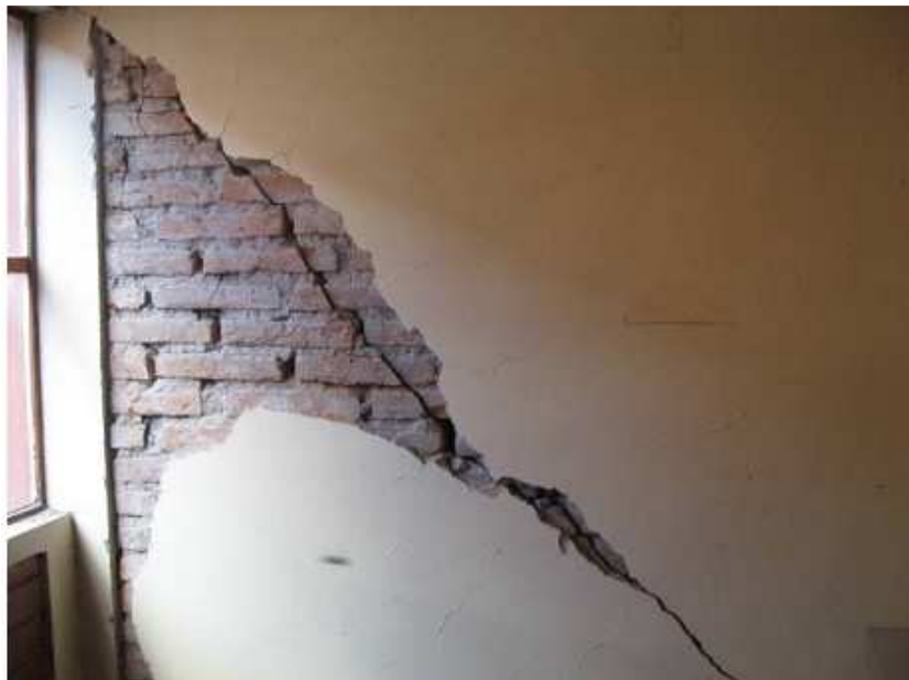
Figura 42: Daño severo por corte en muro divisorio de ladrillo fiscal.
