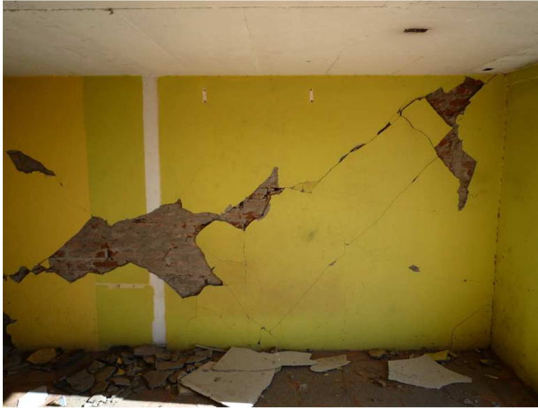
Figura 27: Muro interior de albañilería fiscal con agrietamiento diagonal producto de falla al corte. Además existe caída de abundante estuco.
