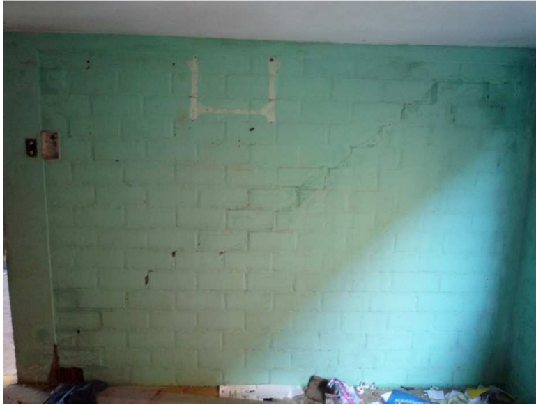
Figura 2: Muro de fachada de albañilería confinada, que presenta una fisura diagonal a través del mortero de pega.
