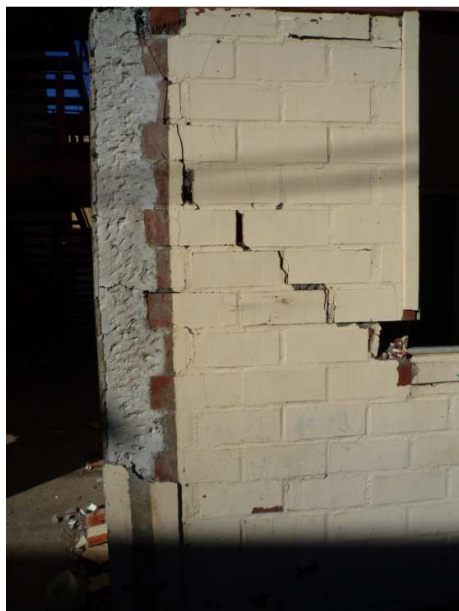
Figura 16: Muro Externo de albañilería con grieta diagonal profunda en el mortero de pega, producto de falla al corte.
