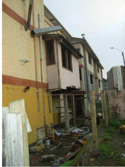
Figura A.2: Ampliación del edificio 7, que alteró estructuración original del edificio.
