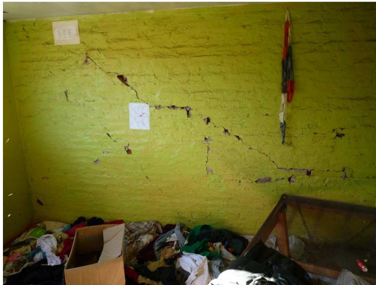
Figura 26: Muro interior de albañilería fiscal con fisura diagonal producto de falla al corte.
