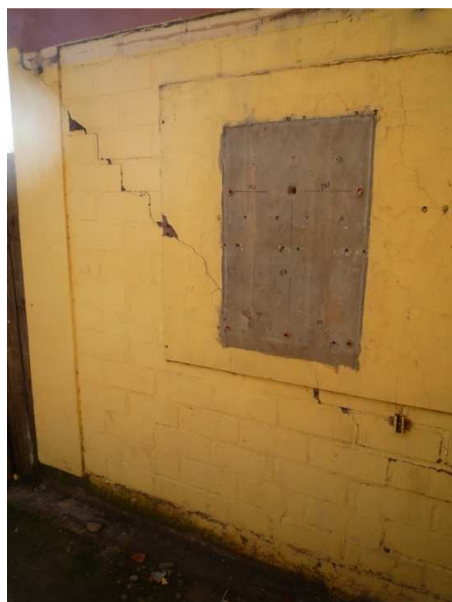
Figura 5: Muro exterior de albañilería confinada, que presenta una grieta en el mortero de pega.
