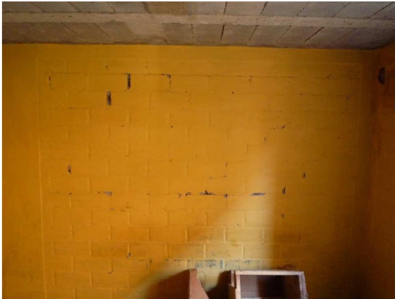
Figura 3: Muro interior de albañilería confinada, que presenta una fisura diagonal a través del mortero de pega.
