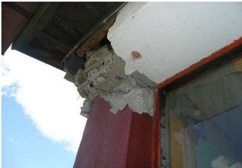
Figura 39: Armadura de refuerzo a la vista en nudo de muro de albañilería.
