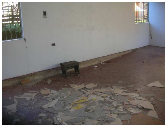
Figura A.4: Radier que presenta un claro asentamiento diferencial. Este asentamiento está presente en diferentes medidas en ambos edificios.
