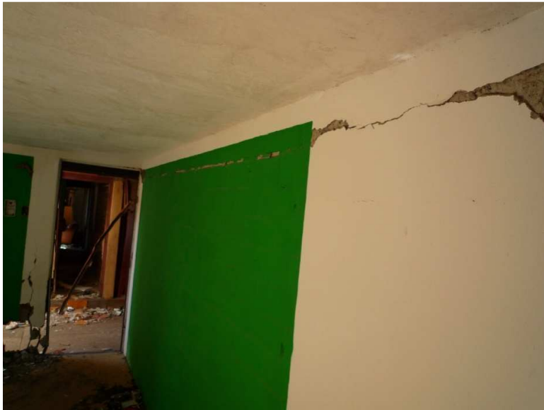
Figura 15: Muro interior longitudinal de albañilería confinada con fisura horizontal a lo largo de todo el muro a través del mortero de pega.
