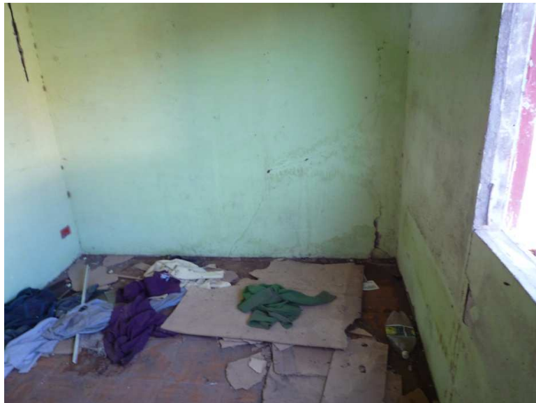
Figura 32: Muro interior de albañilería fiscal con fisura horizontal.
