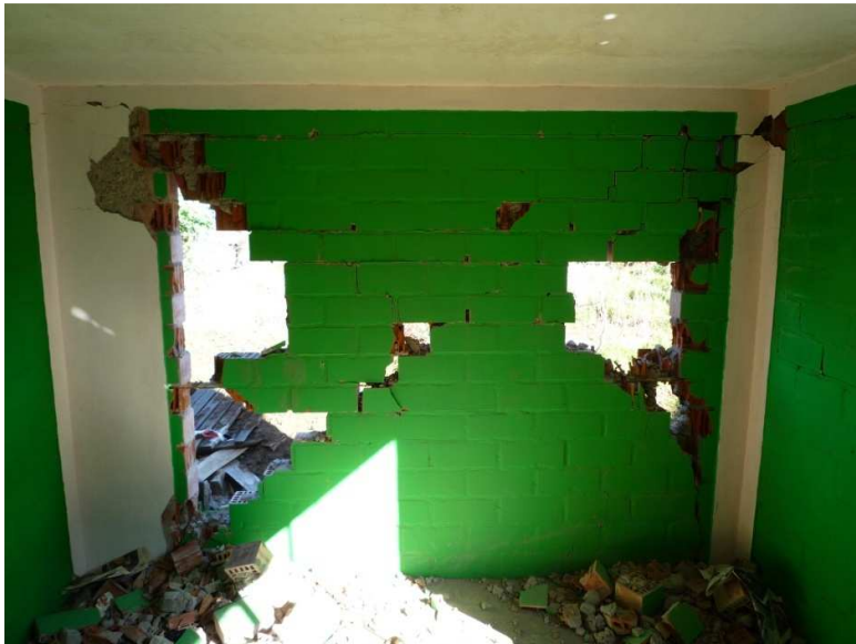
Figura 13: Daño severo de muro de fachada de albañilería confinada, producto de falla al corte. Los pilares presentan grietas que los comprometen.
