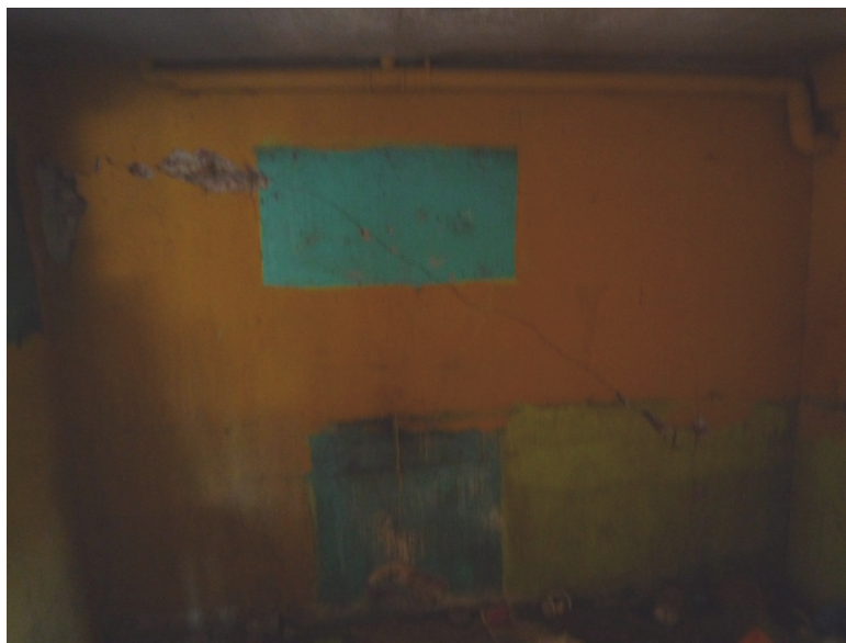
Figura 34: Muro interior de albañilería fiscal confinada, que presenta una fisura diagonal producto de una falla al corte.
