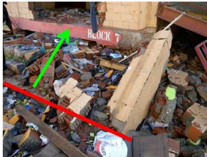
Figura A.3: Desplazamientos que sufrieron los edificios 9 y 10 al colapsar los muros longitudinales que a su vez indujeron a una falla fuera del plano de los muros longitudinales.
