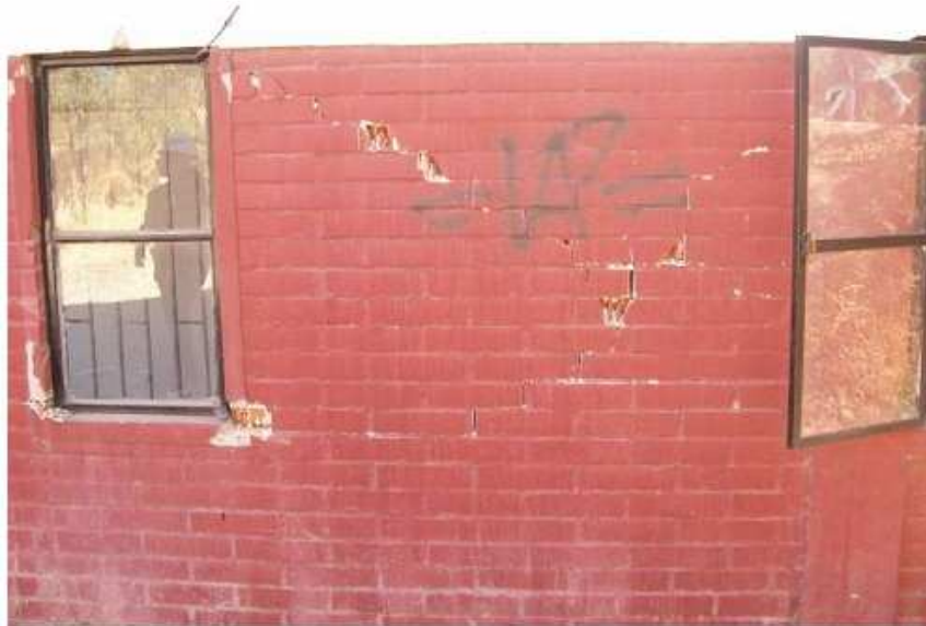
Figura 41: Grietas diagonales de corte (formando una x) en muro de albañilería.
