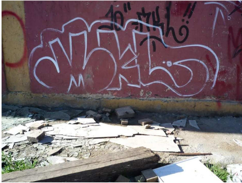
Figura 29: Muro exterior de albañilería fiscal con fisura horizontal en estuco.
