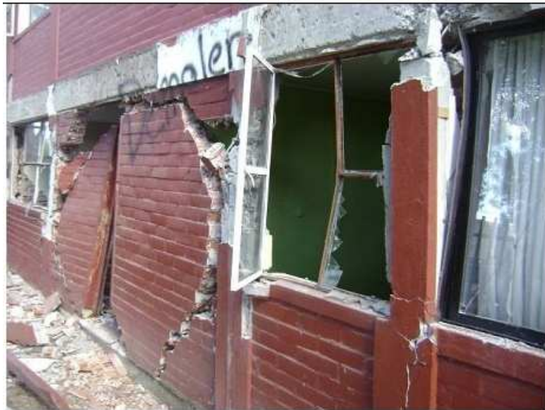
Figura 37: Daño severo en muro exterior longitudinal de albañilería producto del esfuerzo a corte.
