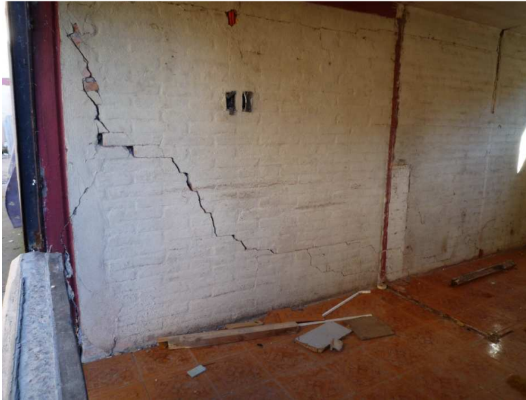
Figura 23: Muro interior de albañilería fiscal confinada con agrietamiento profundo diagonal. Pilar dañado con grieta vertical.
