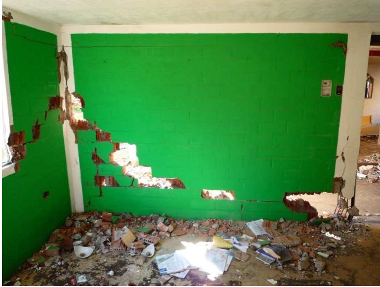
Figura 14: Daño severo de muro externo de albañilería confinada producto de una falla por corte. Pilar con pérdida del hormigón y pandeo de la armadura en la parte baja.
