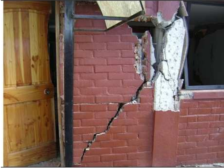
Figura 38: Daño estructural severo en muro de albañilería y daño severo en pilar de confinamiento.
