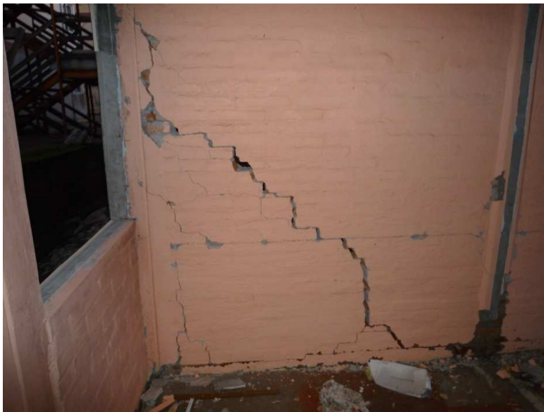
Figura 20: Muro interior de albañilería fiscal confinada con agrietamiento profundo diagonal.
