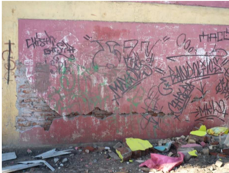
Figura 33: Muro exterior de albañilería fiscal confinada, que presenta una fisura diagonal y horizontal producto de una falla al corte.
