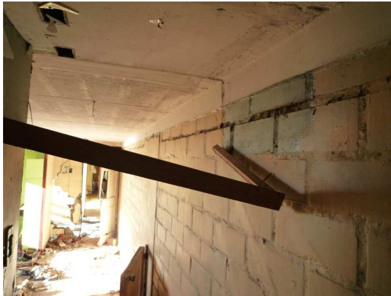
Figura 9: Muro longitudinal interior de albañilería confinada, que presenta una fisura horizontal a lo largo de todo el muro en el mortero de pega, producto de un desplazamiento perpendicular al muro.
