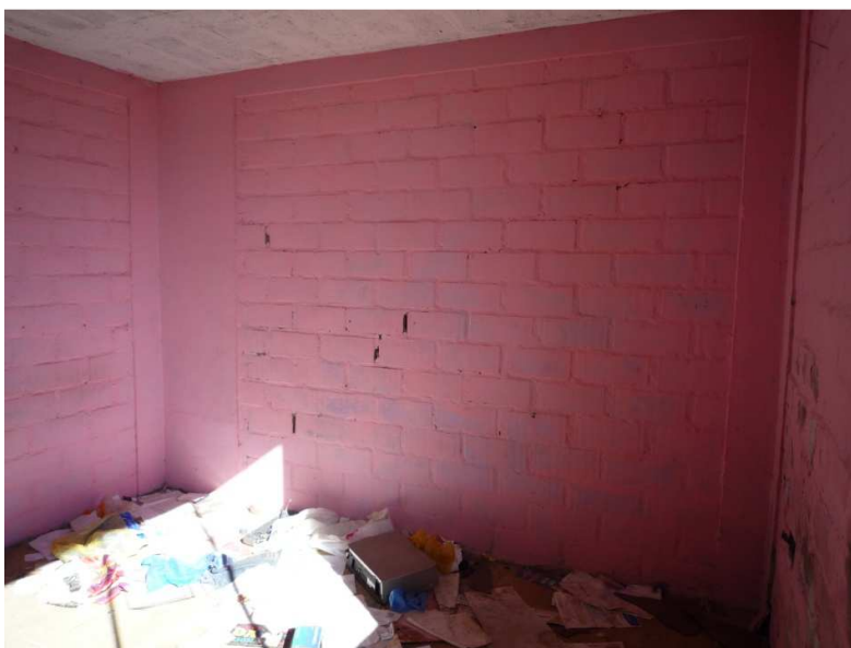
Figura 4: Muro interior de albañilería confinada, que presenta una fisura diagonal en el mortero de pega.
