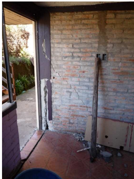
Figura 24: Muro interior de albañilería fiscal confinada con fisura diagonal y agrietamiento profundo vertical del pilar de confinamiento.
