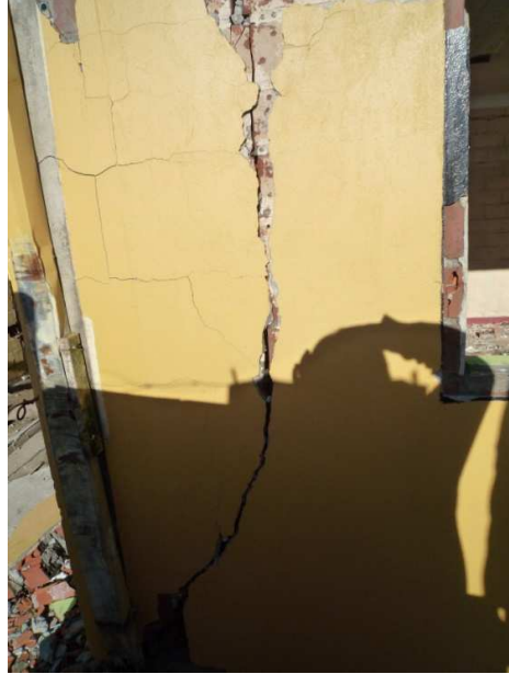
Figura 8: Agrietamiento vertical profundo de muro externo de albañilería.
