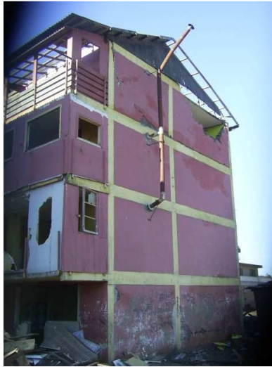
Figura A.6: Muro exterior de albañilería fiscal confinada, que presenta grave daño al vaciarse parte importante del paño de albañilería (edificio 4, cuarto piso)
