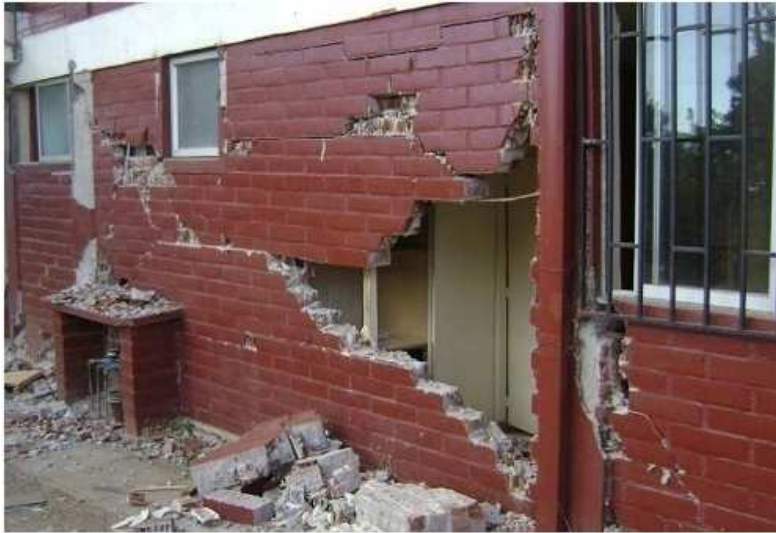
Figura 36: Daño severo en muro exterior de albañilería producto del esfuerzo a corte.
