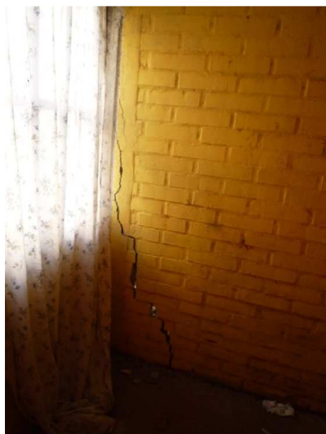
Figura 25: Muro interior de albañilería fiscal confinada con agrietamiento profundo diagonal.
