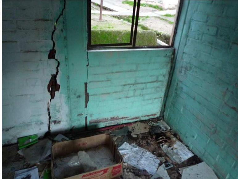
Figura 21: Muro exterior de albañilería fiscal con agrietamiento profundo vertical.
