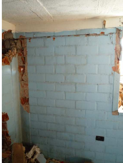
Figura 10: Muro de fachada longitudinal de albañilería, que presenta una fisura y deslizamiento fuera del plano a través del mortero de pega.
