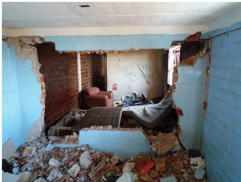
Figura 11: Colapso de muro interno de albañilería confinada, producto de falla al corte. Existe compromiso del machón izquierdo agrietado profundamente.
