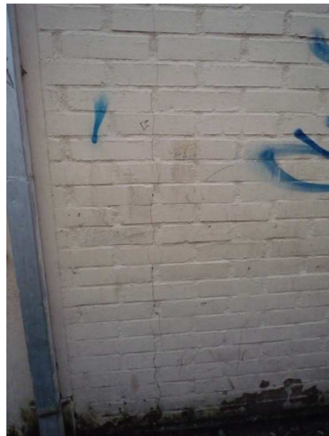
Figura 22: Muro exterior de albañilería con fisura vertical.
