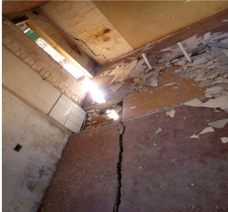
Figura A.5: Asentamiento en radier que induce falla muro de albañilería fiscal.
