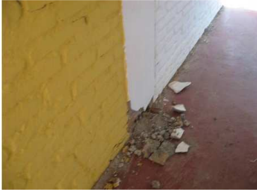
Figura 44: Daño por compresión en elemento de confinamiento.
