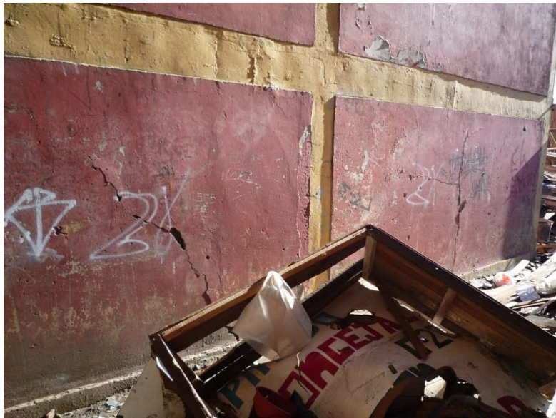
Figura 30: Muro exterior de albañilería fiscal con fisura diagonal (que involucra estuco y ladrillo) producto de falla al corte.
