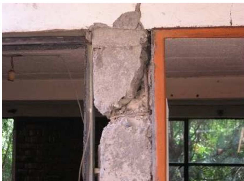
Figura 43: Falla de columna corta, con pérdida del recubrimiento de hormigón.
