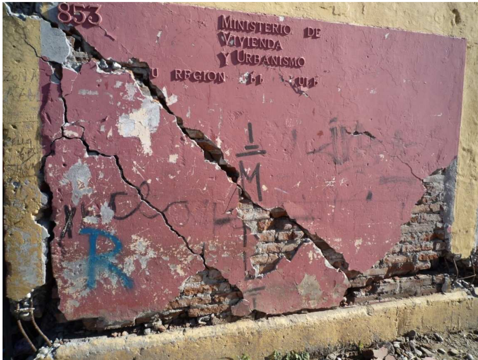
Figura 28: Muro exterior de albañilería fiscal con daño estructural severo producto de falla al corte. Pilares y machones con daño severo por pérdida de hormigón y pandeo de Armadura.
