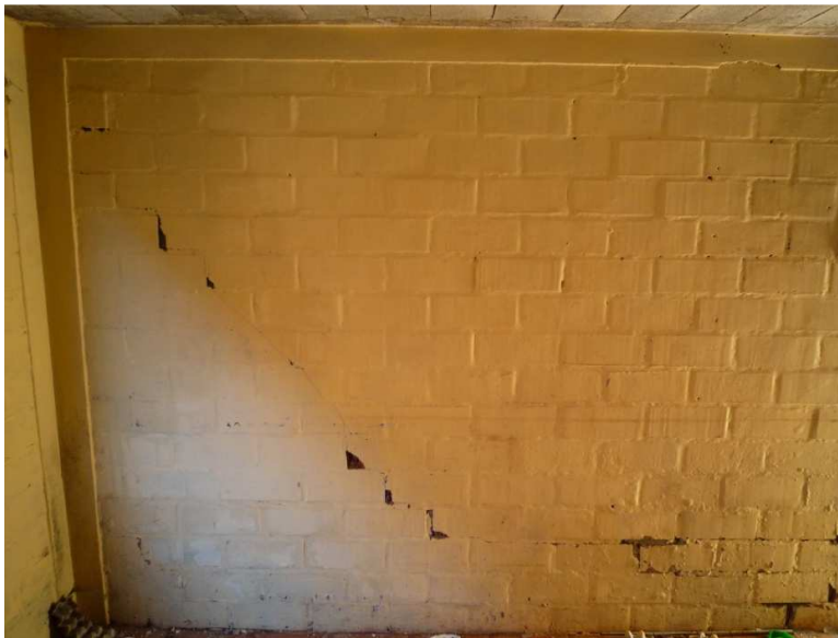
Figura 1: Muro de fachada de albañilería confinada, que presenta una fisura diagonal en el mortero de pega.
