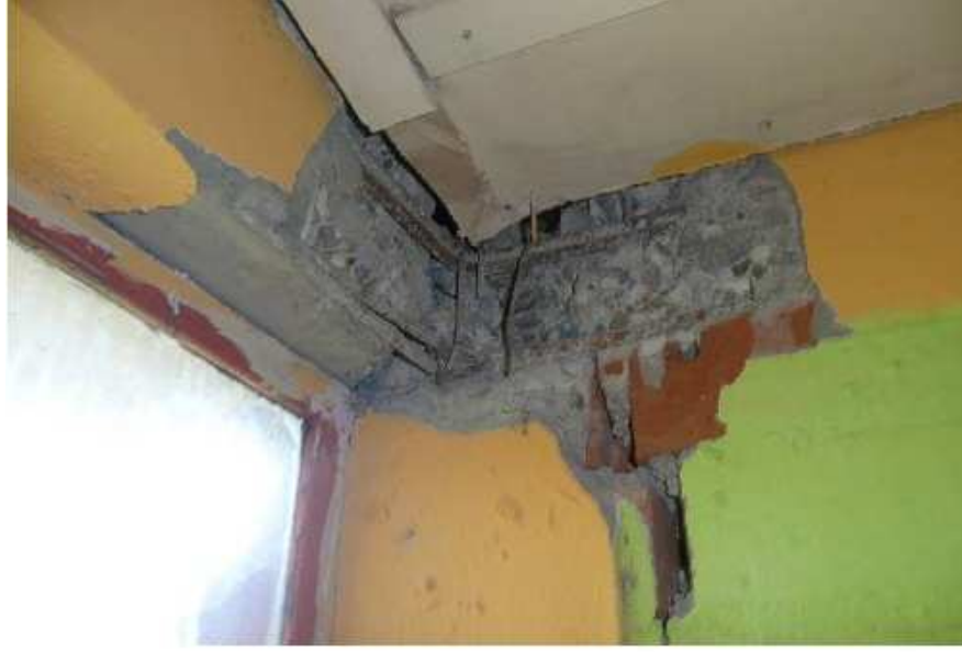
Figura 40: Perdida de recubrimiento en Nudo.
