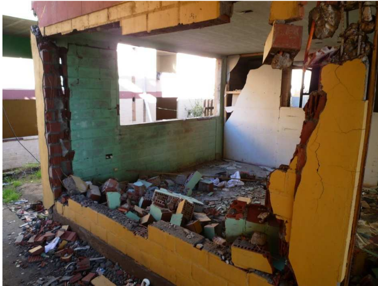
Figura 6: Colapso de muro de fachada de albañilería confinada, producto de falla al corte. Además existe compromiso de los pilares de confinamiento al perder casi la totalidad de su hormigón y pandear su armadura.
