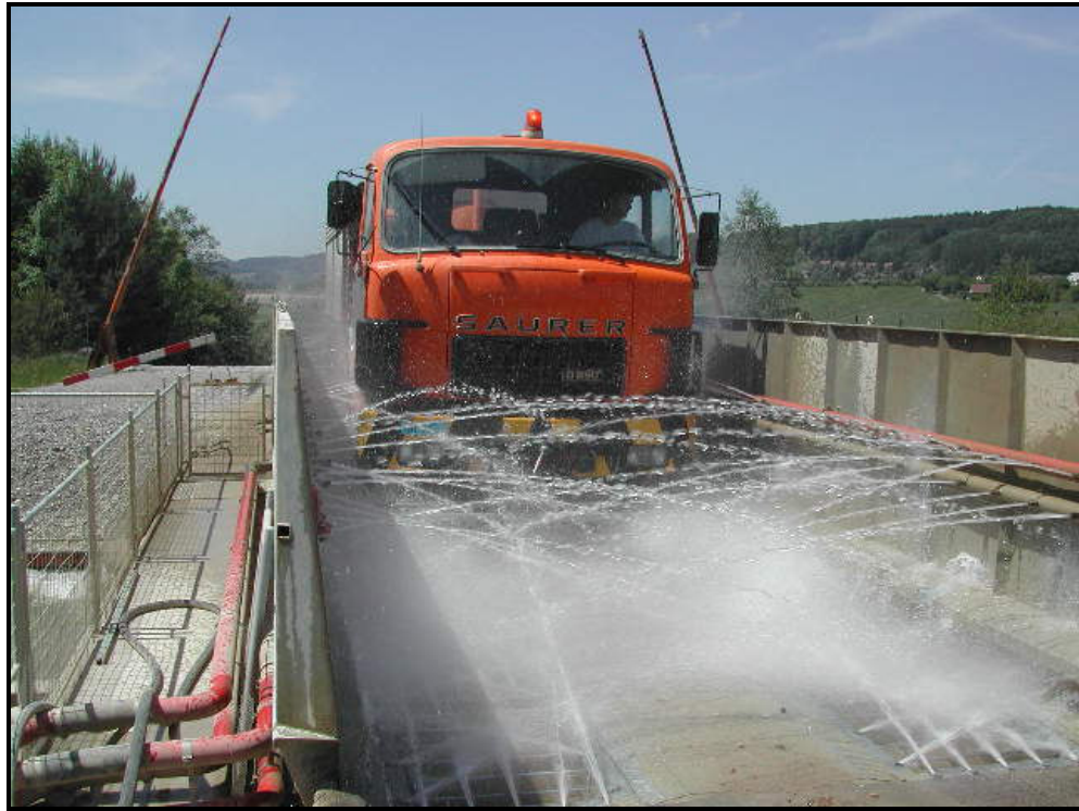
Fig. Nº 18: Instalación de limpieza de neumáticos de camiones.
