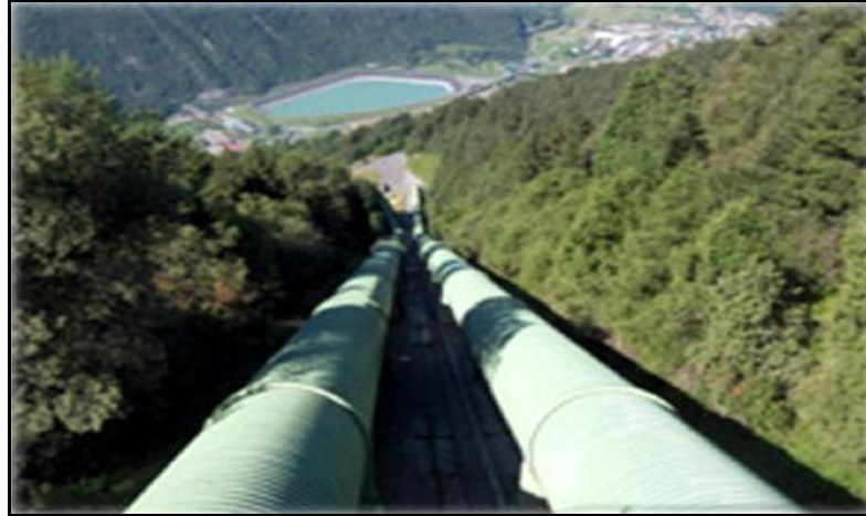
Figura 21: Tuberías de conexión entre reservorios de la central Piastra Edolo, Italia.
