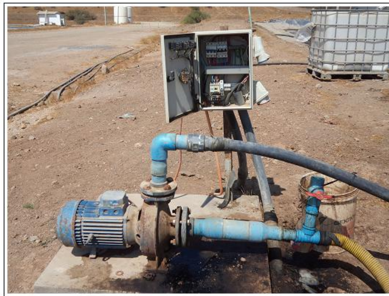
Figura 5.13 Bomba hidráulica utilizada para recirculación de la Bandeja N°3 al estanque
