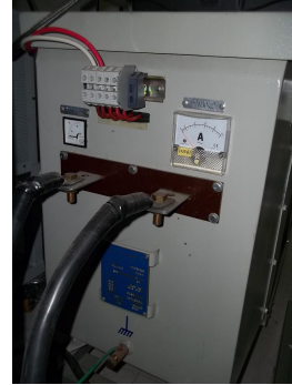
(b) Panel de control del transformador.
