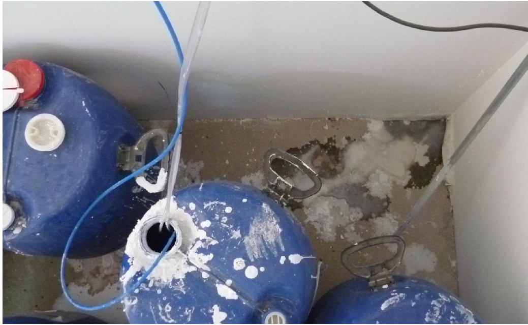
Figura 4-19 Lugar de almacenamiento y dosificación del hidróxido de sodio (sala de químicos)
