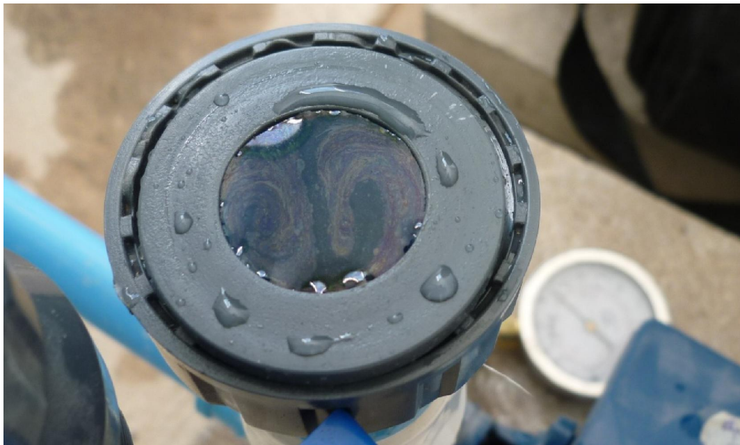
Figura 4-10 Fotografía de una unión americana abierta. Se puede observar la presencia del componente bituminoso en la superficie del agua
