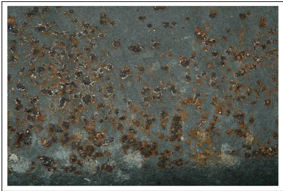
Figura N o 1.4: Superficie externa de una tina de hierro corroída por pitting [8].
