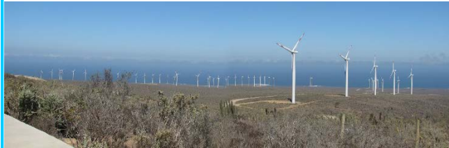
Parque Eólico Canela, IV Región FUENTE: Ministerio de Energía
