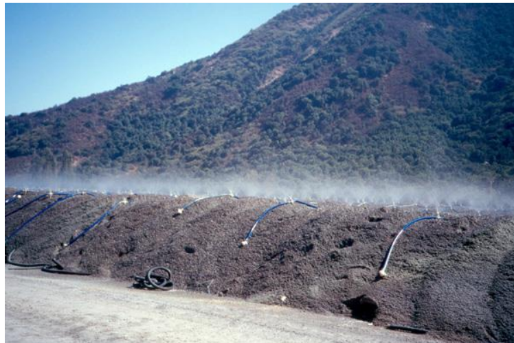
Figura 3.7 Aspersores en pila de lixiviación.
