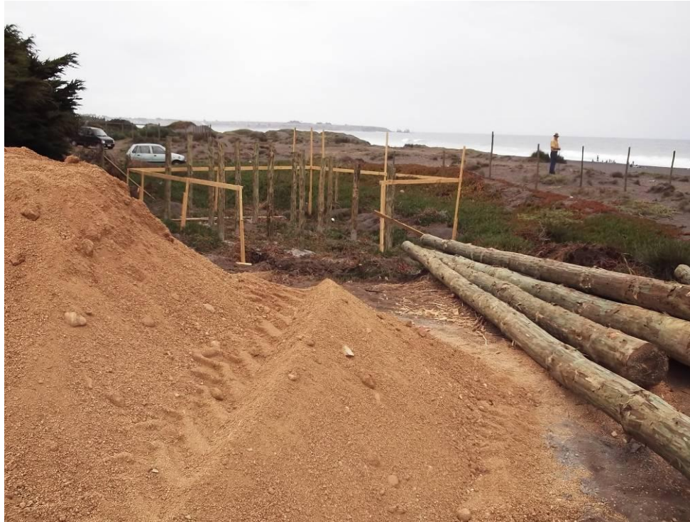
Figura N°59: Imagen de construcción sobre dunas en el sector de Playa Hermosa
