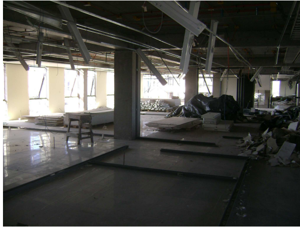
ILUSTRACIÓN 43 - TABIQUERÍA, DUCTOS DE VENTILACIÓN, LUMINARIA Y BAÑOS DEL PISO 3 100% DAÑADAS
