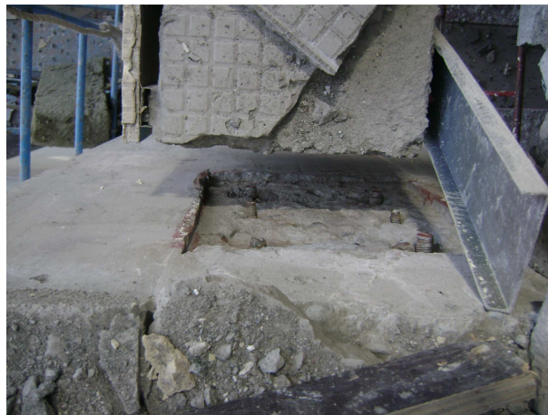
ILUSTRACIÓN 40 -PERNOS CORTADOS EN FLANGE DE VIGA METÁLICA ESCALA.
