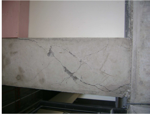
ILUSTRACIÓN 41 - VIGA HORMIGÓN ESCALA FRACTURADA.
