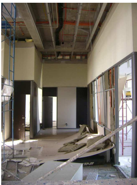
ILUSTRACIÓN 45 - CAÍDA PARCIAL TABIQUERÍA Y LUMINARIA PISO 1.
