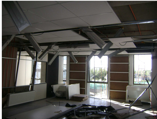
ILUSTRACIÓN 44 - PÉRDIDA CASI TOTAL EN TABIQUERÍA, DUCTOS DE VENTILACIÓN Y LUMINARIA DEL PISO 2.
