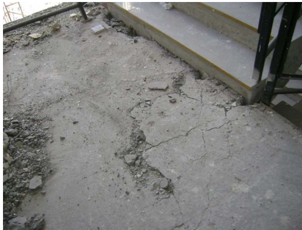
ILUSTRACIÓN 39 -LOSA DESCANSO ESCALA FRACTURADA.
