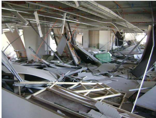
ILUSTRACIÓN 42 - TABIQUERÍA, DUCTOS DE VENTILACIÓN, LUMINARIA Y BAÑOS DEL 4º PISO 100% DAÑADAS.
