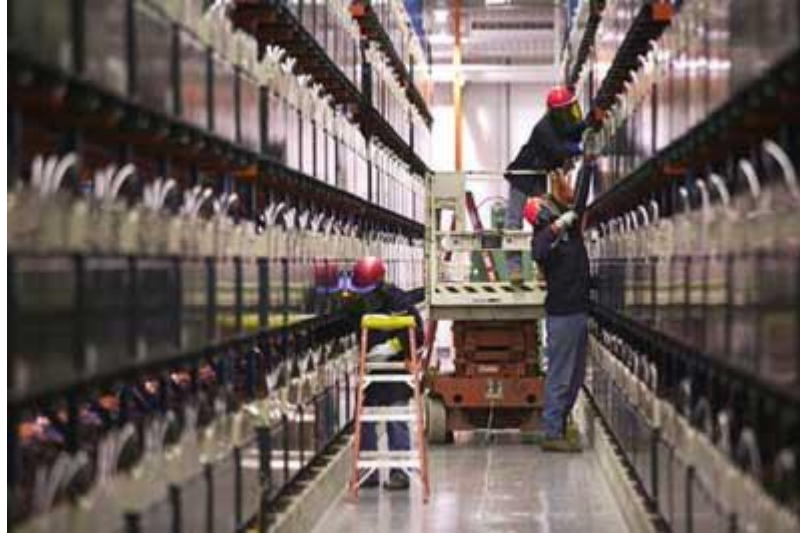
Figura 2.14 BESS de NiCd en Fairbanks, Alaska, EEUU [21]
