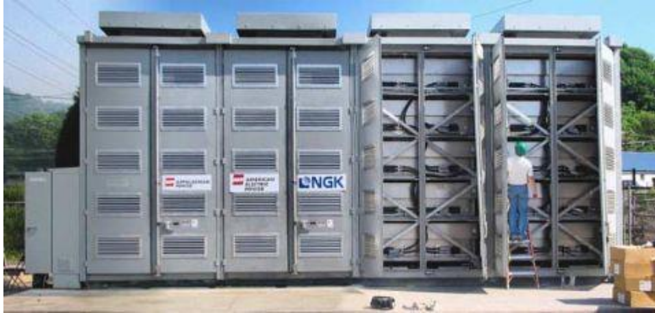
Figura 2.9-Batería de NaS en Charleston, Estados Unidos [8]
