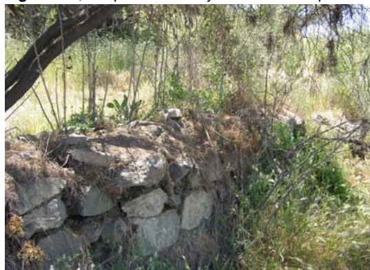
Fig. 89. Vegetación en estructuras y muros.
