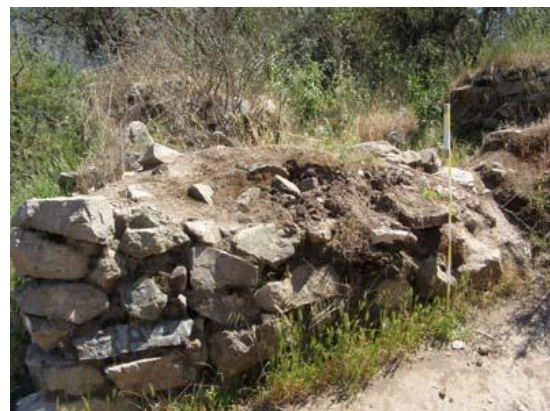
Fig. 86. Degradación de morteros de tierra.
