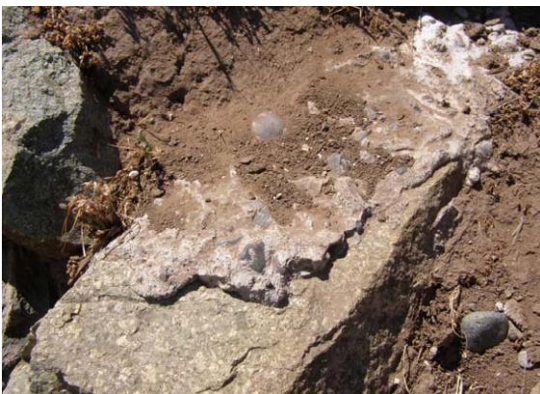
Fig. 90. Resto de mortero de concreto de reconstrucción.
