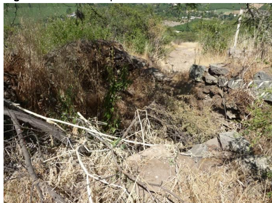
Fig. 88. R1, colapso de muros y crecimiento de plantas.
