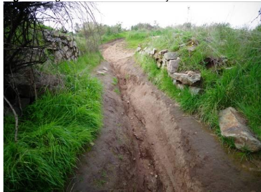
Fig. 91. R1, colapso de muros y crecimiento de plantas.
