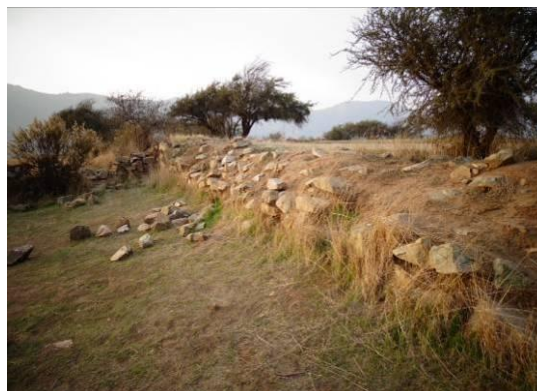
Fig. 87. Derrumbe de parte de muro.
