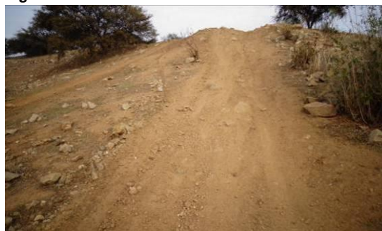
Fig. 8. Proceso erosivo desgaste uso antrópico.
