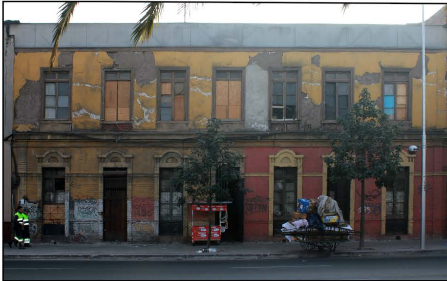
Figura 11 - Inmueble de Conservación Histórica en deterioro
