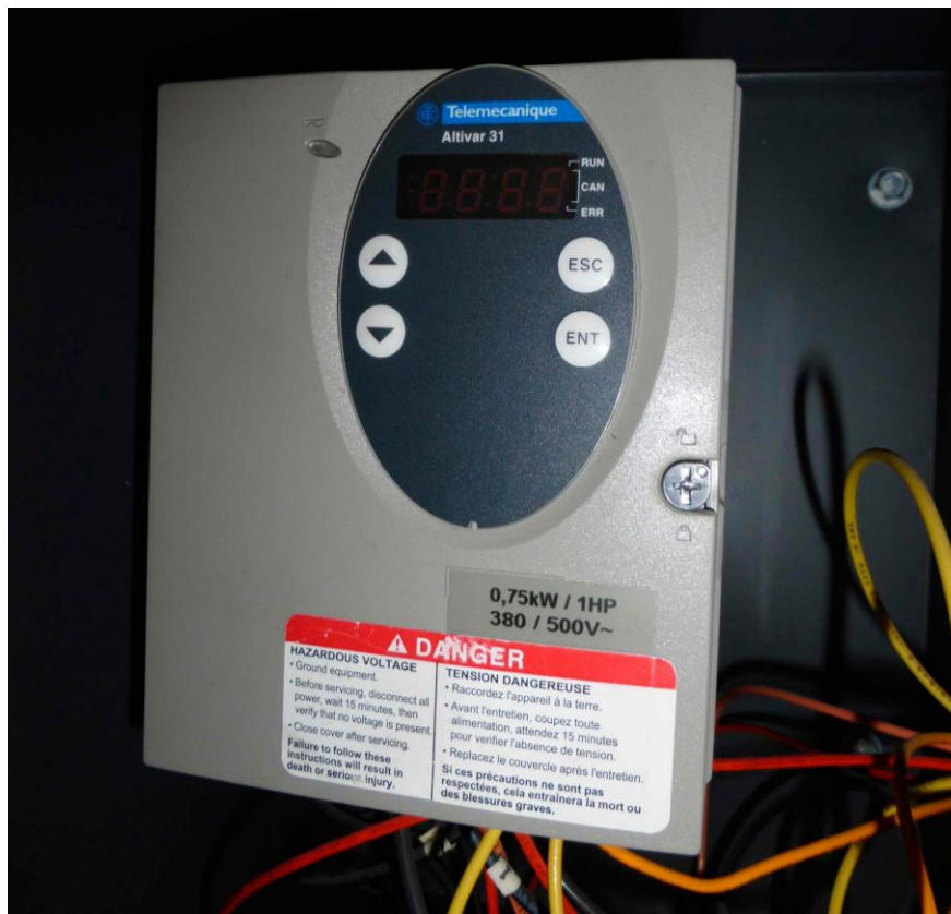
Figura 5.4: Variador de Frecuencia
