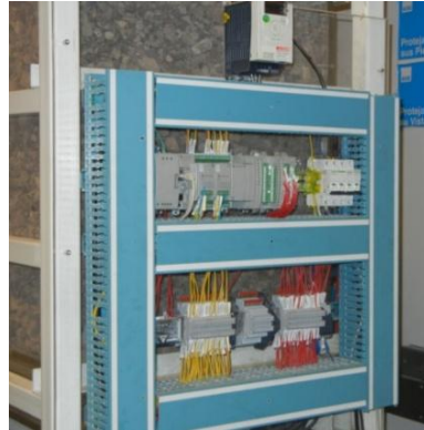
Figura 3.12. Vista general de estructura contenedora de PLC y paneles eléctricos de alimentación de energía, así como activación de Panzer
