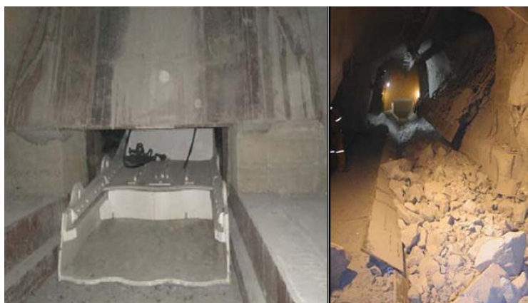
Figura 2.8. Dozer (Izquierda) y Panzer (Derecha) instalados en División Salvador
