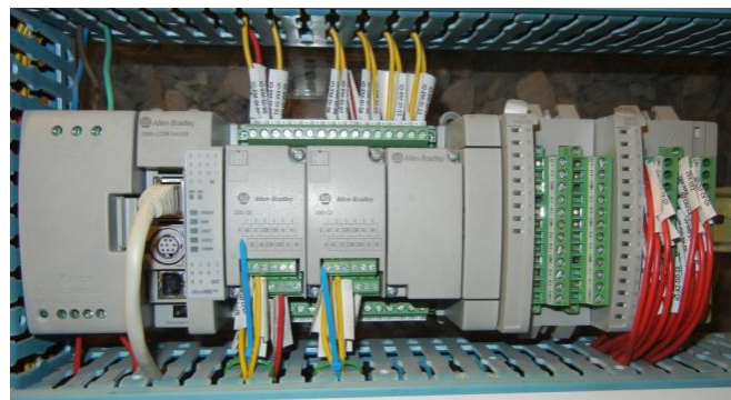
Figura 3.13. Vista frontal de PLC empleado
