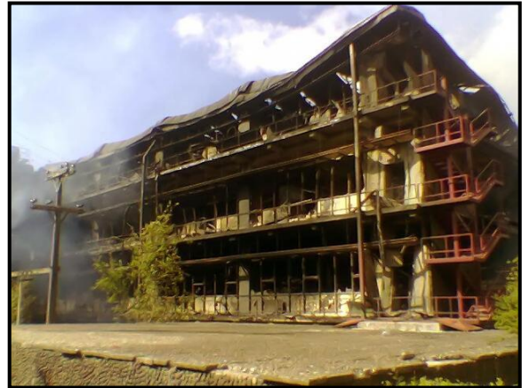
Edificio de la UACH luego del incendio
