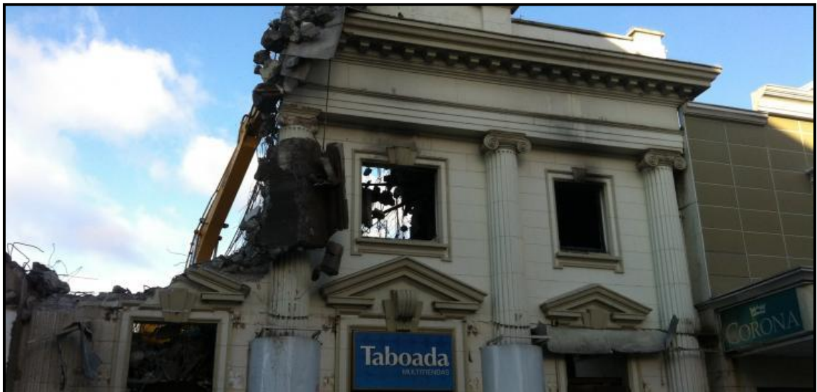
La fachada de la tienda Taboada al momento de su demolición, días después del incendio.
