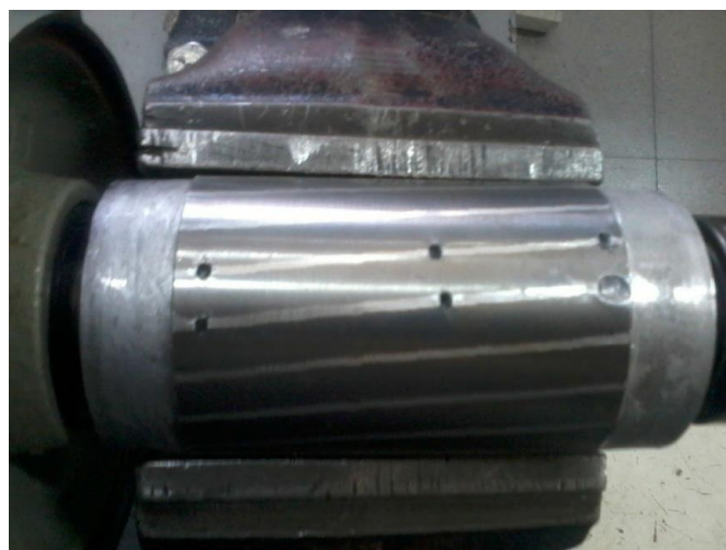
Figura 3-6: Rotor del motor con barra rota
