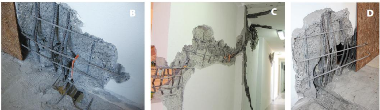
Figura 1.1: Daños debido a irregularidades en el primer piso Torre Bosquemar, Concepción.
