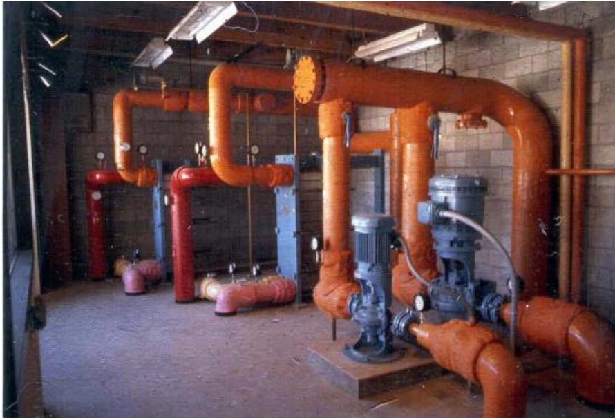
Figura 4-28: Intercambiador de calor de placas y bombas de circulación en sistema de calefacción distrital geotérmico en Oregón, EEUU. Fuente: [34].
