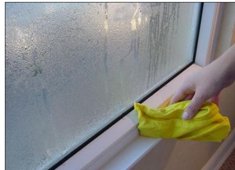
Figura 2.25: Condensación superficial en ventana
