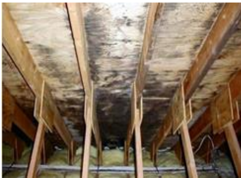
Figura 2.24: Condensación en techumbre
