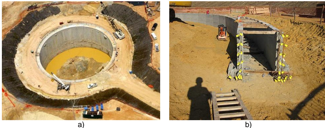
Figura 34: Pique con muro pantalla en planta de procesamiento de acero inoxidable en Alabama, Estados Unidos. a) Muro pantalla. b) Construcción muro guía. Bauer (2014).
