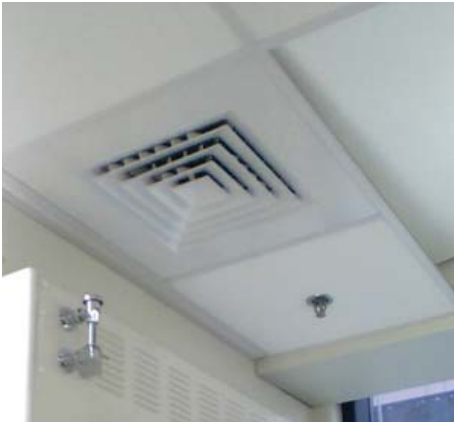
Imágen, arriba Cielo registrable de yeso con sprinkler
