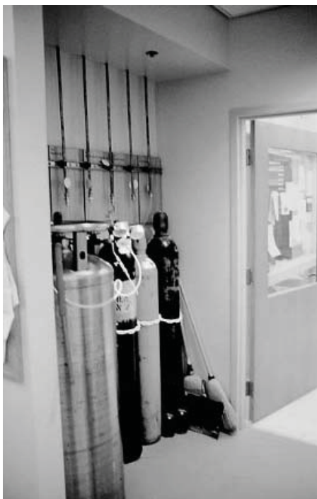
imagen, arriba Almacenamiento de cilindros de gas al interior de una celda de lab.
