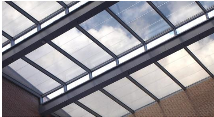
Figura 2.21: Instalación de vidrio fotovoltaico transparente en Edificio Lucía, Valladolid. Fuente: Onix solar [35]
