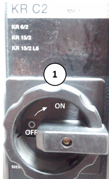
Figura 7.9: Switch encendido KUKA .
