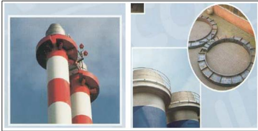
Figura 1-11. TLDs instalados en chimeneas [51].
