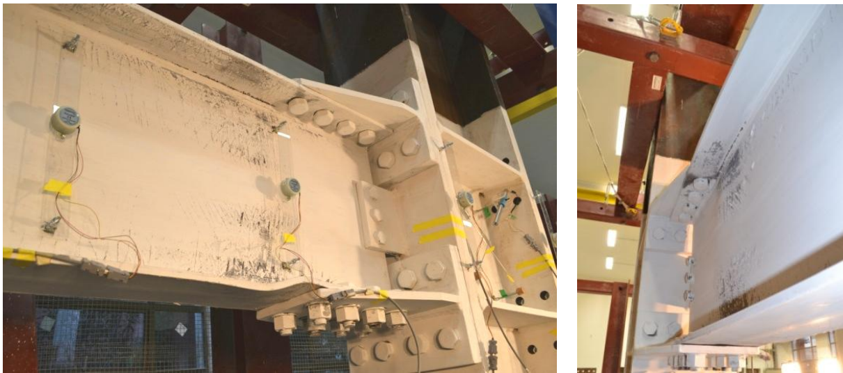
Figura 6.36: Pandeo local alas y alma de la viga para el ciclo 1 de la distorsión de piso \theta=0,05 [rad].
