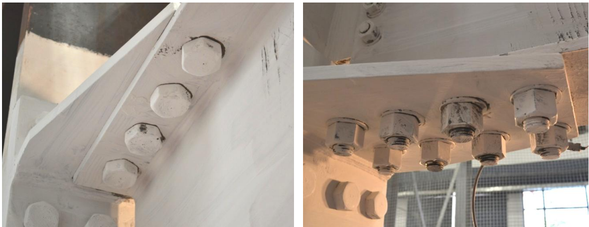
Figura 6.28: Deslizamiento observado en los pernos sometidos a corte para \theta=0,03 [rad].
