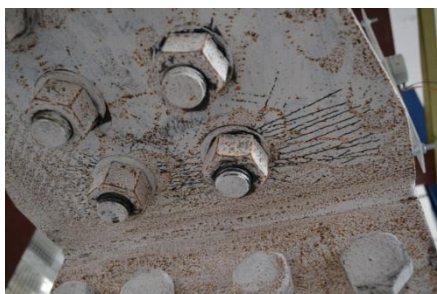
Figura 6.11: T-stub inferior oeste post-ensayo SE-01.
