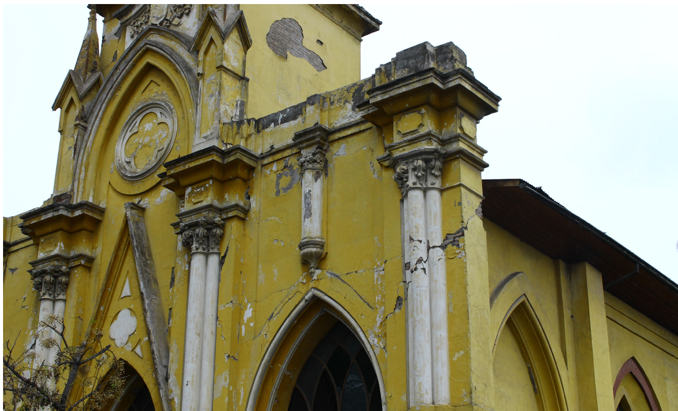
Fotografía de elaboración propia. Daños en fachada principal del templo neogótico.
