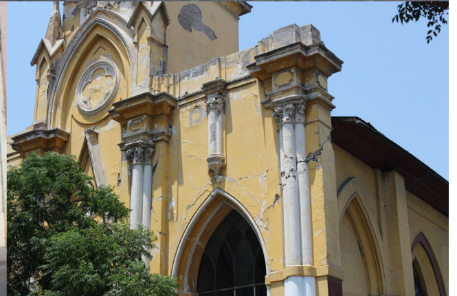
Fotografías de elaboración propia. Algunos casos de edificios deteriorados del barrio Yungay.
