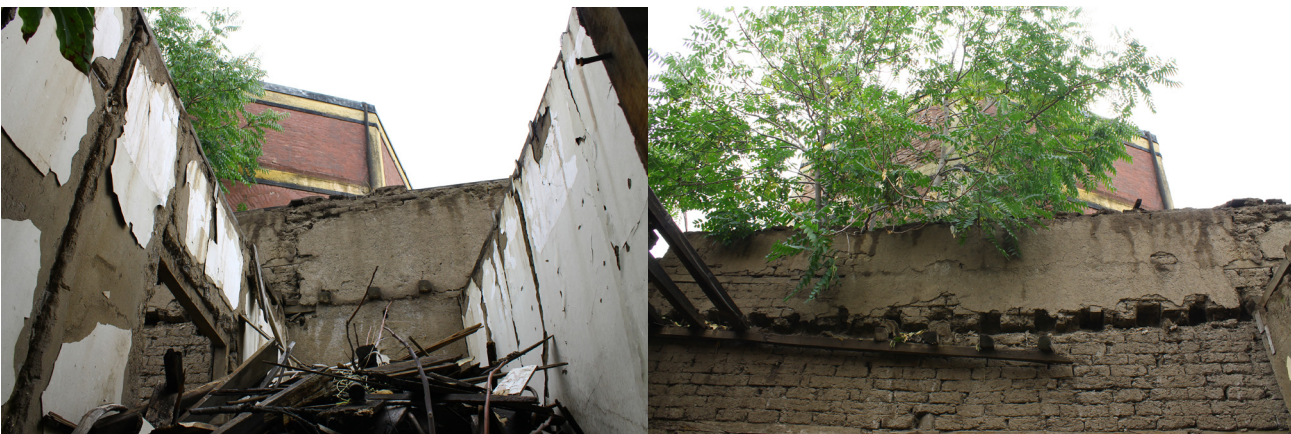
Fotografías de elaboración propia. Obstrucción de vista al ábside por muros de la casa parroquial.
