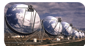
Vista general de los discos parabólicos del laboratorio de envejecimiento y durabilidad. de la PSA
