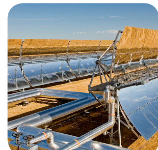
Planta de Cilindros Parabólicos Planta termosolar Alvarado, España
