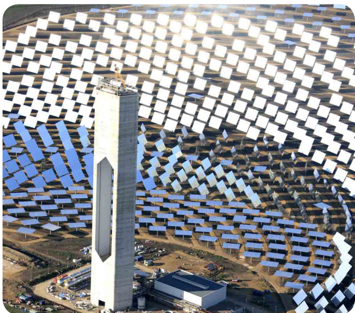
Torre de Concentración Abengoa + Heliostatos (Img Google)
