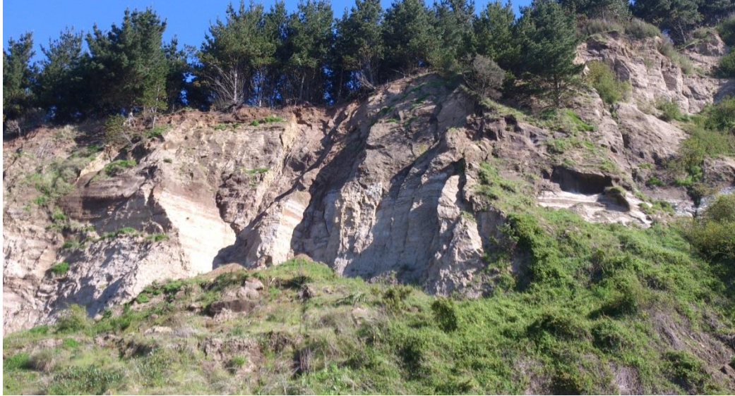
Figura 38: Vista general segundo deslizamiento.
