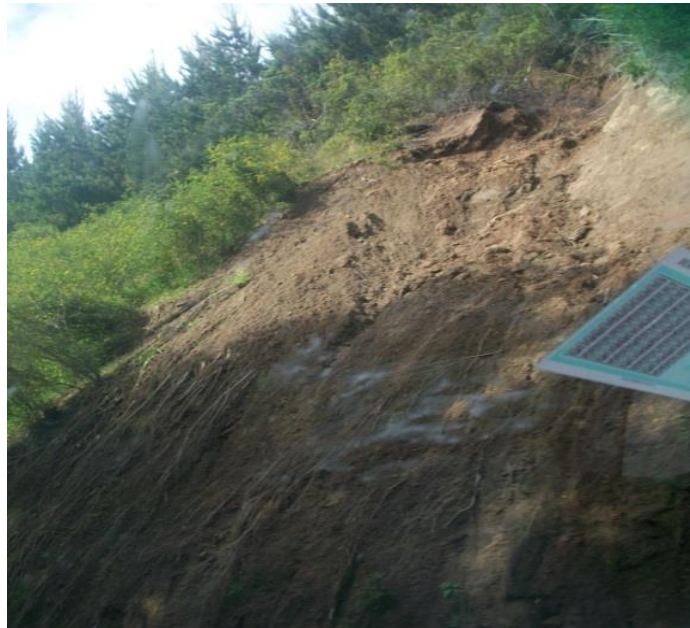
Figura 28: Deslizamiento superficial Camino Tubul-Caleta Las Peñas.
