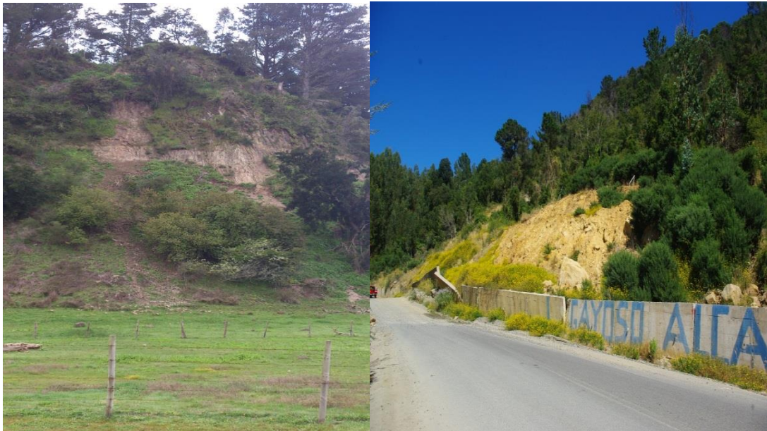
Figura 35: Deslizamiento suelo y roca, al oeste del río Tubul (Izq). Deslizamiento suelo y roca en el camino entre Llico y Pta. Lavapié (Der.)
