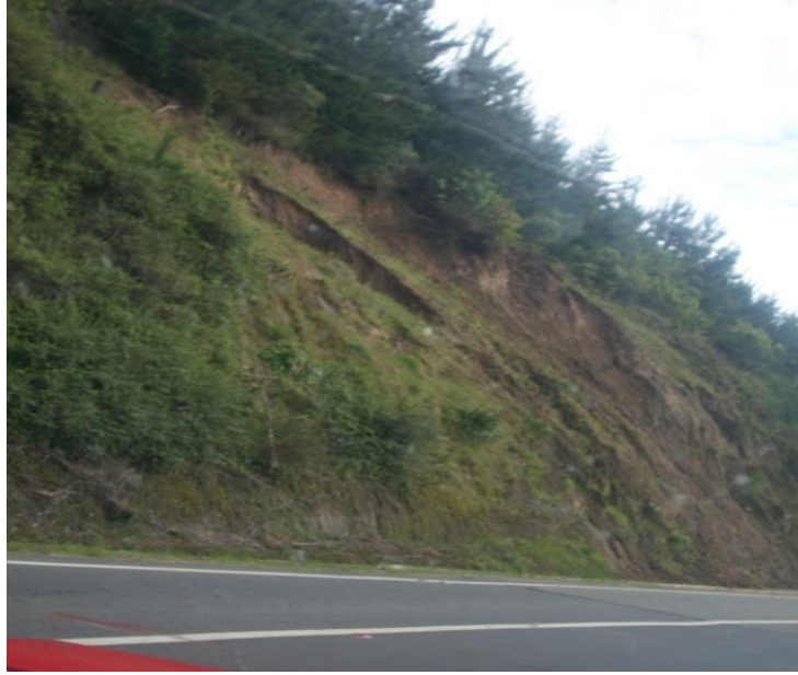
Figura 27: Deslizamiento superficial Camino Tubul-Caleta Las Peñas.
