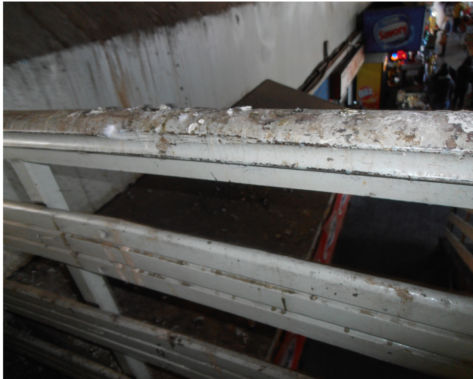
Fig. 14 Deterioro infraestructura terminal rodoviario
