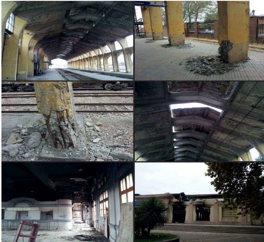
Fig. 11 Daños post-terremoto Estación de trenes
