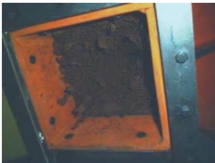
Figura 4.3: Atasco en la salida de la tolva del silo de ensayo. Fuente: Elaboración Propia.
