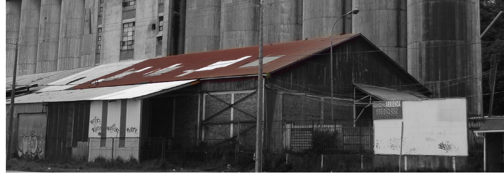
OXIDACIÓN REVESTIMIENTO DE CUBIERTA
