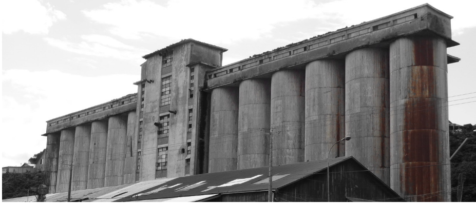
OXIDACIÓN REVESTIMIENTO DE FACHADA
