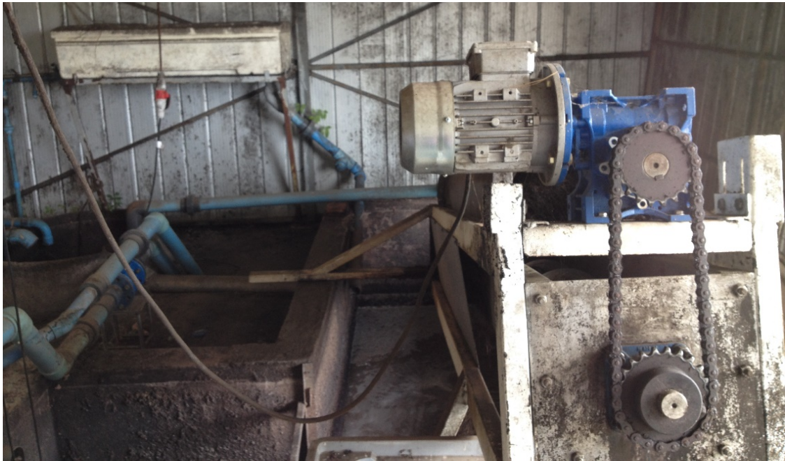
Figura 3. Fotografía separador de sólidos
