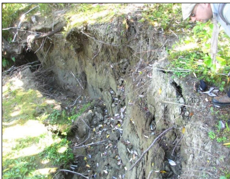
Figura 4.4: Deslizamiento de suelo menor en las cercanías del río Lloncochaigua.
