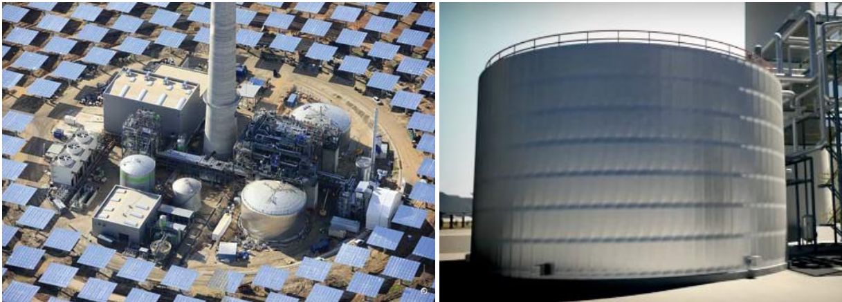
Figura 3.18 Tanques de almacenamiento de Central Gemasolar
