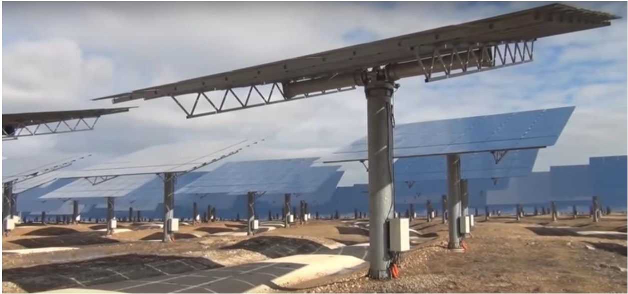
Figura 3.12 Campo de helióstatos de planta Gemasolar
