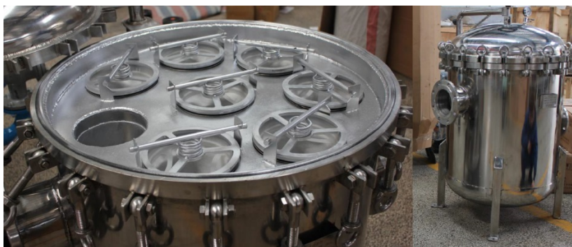
Figura 4.13: Sistema de filtración de micro cartuchos. A la izquierda se observa el recipiente de acero inoxidable visto superiormente con los cartuchos instalados en su interior. A la derecha se tiene una visión frontal del recipiente (EP).
