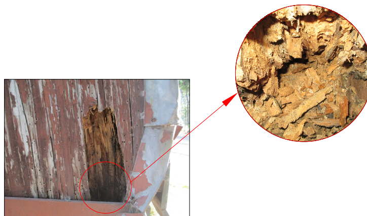
Figura 3.4: Pudrición en el apoyo de la primera viga laminada. Fuente: Elaboración propia.
