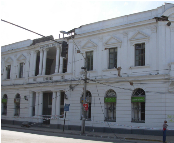
Banco BCI con daños estructurales por terremoto
