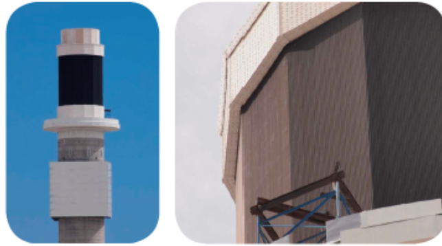
Figura 1.15: Receptor de sal fundida de central Crescent Dunes, Estados Unidos. Fuente: [19]
