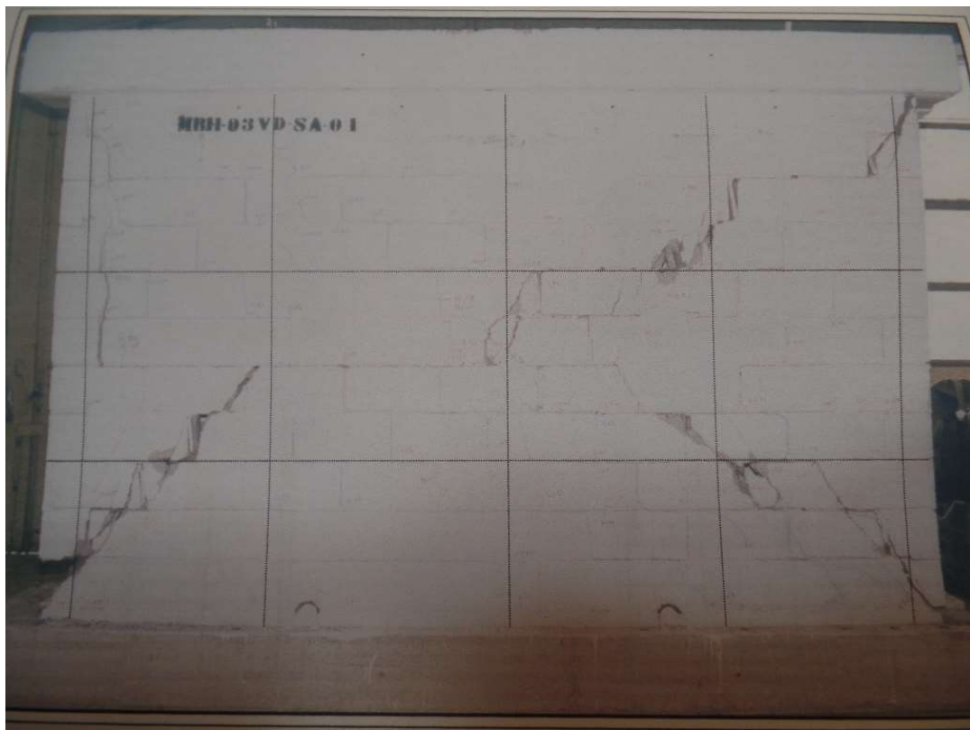
Figura 0.7. Muro 20, MBH-03VD-SA01 (Sierra, 2002).
