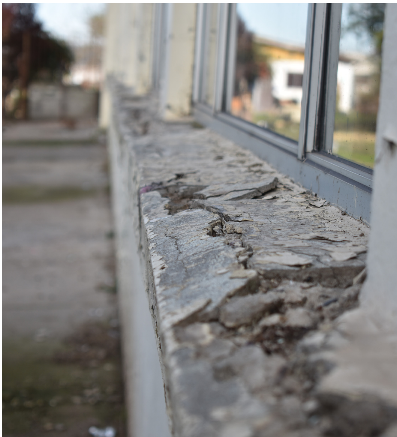
Imagen 12 : Daños Escuela España Fuente: Archivo FONDECYT
