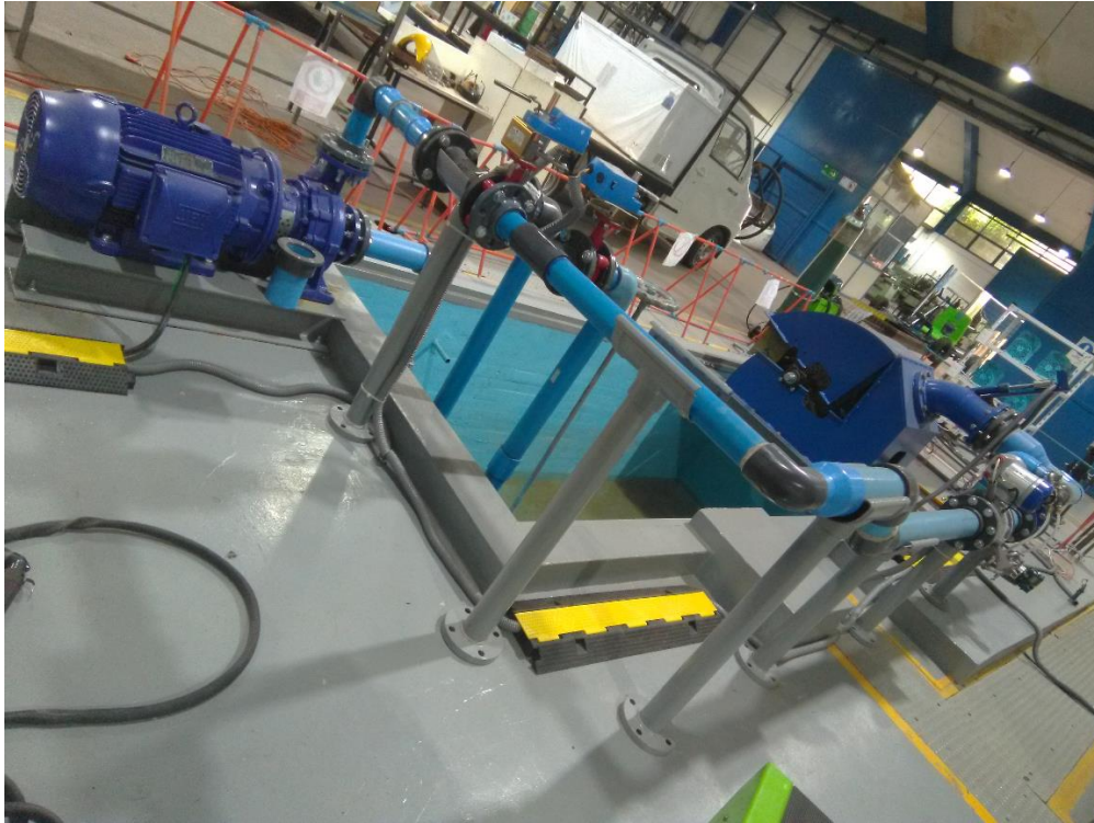
Figura H.1: Vista general del laboratorio que contiene a la microcentral hidráulica.
