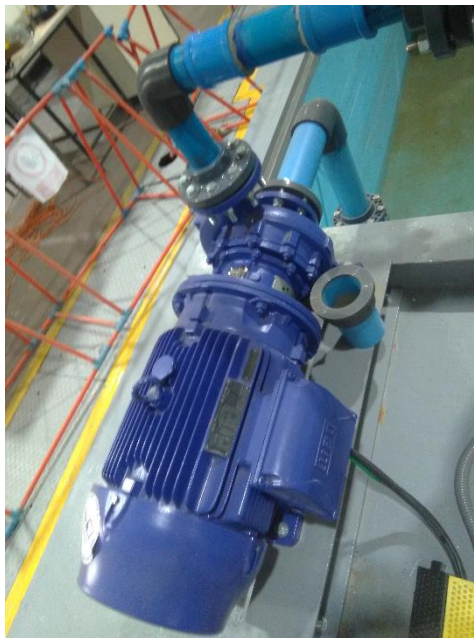
Figura H.6: Bomba regalada para la microcentral hidráulica.
