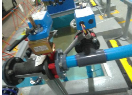
Figura H.7: Vista general de válvulas.
