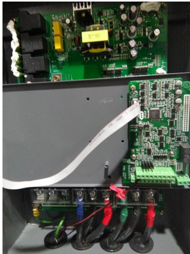
Figura H.4: Interior de variador de frecuencia electrificado y conectado su control.
