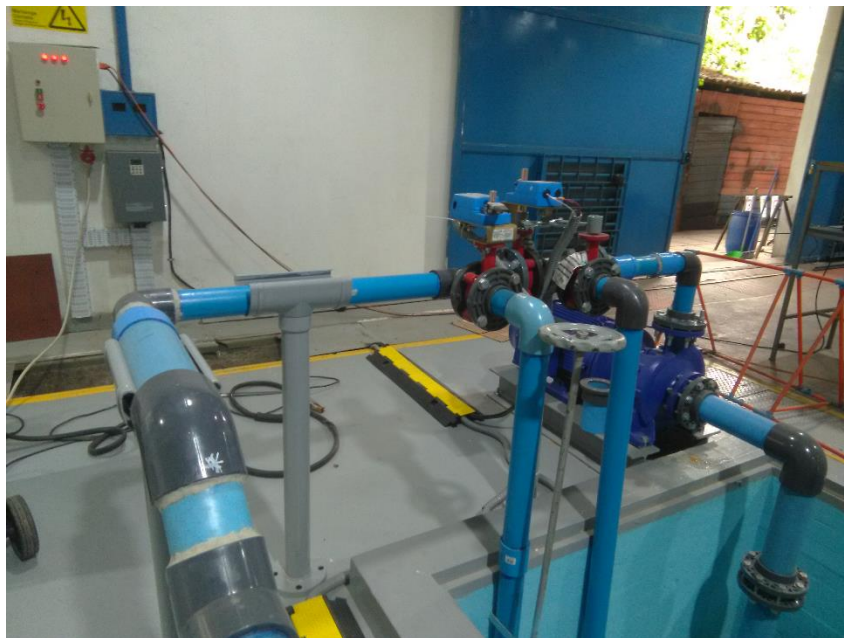
Figura H.2: Vista particular del laboratorio que contiene a la microcentral hidráulica, centrado en tablero eléctrico, variador de frecuencia y válvulas requeridas.
