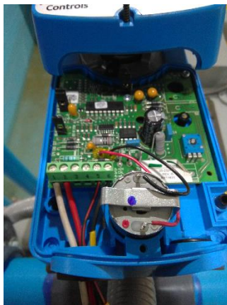
Figura H.10: Detalle de conexiones de válvula reguladora de sobredimensionamiento de la bomba.
