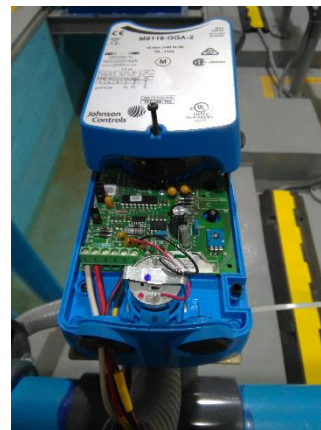
Figura H.11: Conexiones y tapa de válvula reguladora de sobredimensionamiento de la bomba M9116-GGA-2.
